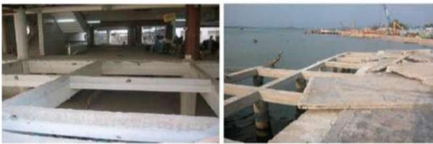
Gambar 2.20 Kerusakan panel lantai beton pracetak di dermaga pelabuhan (Foto milik M. Saadoglu, A. Ghoberah dan I. Nistor, CAEE, 2005)
