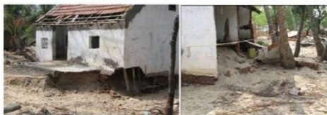
Gambar 2.13 Rumah pasangan bata di pantai yang rusak di Devanapattinam, India oleh Tsunami Aceh 2004 | (FEMA P646, 2008).
